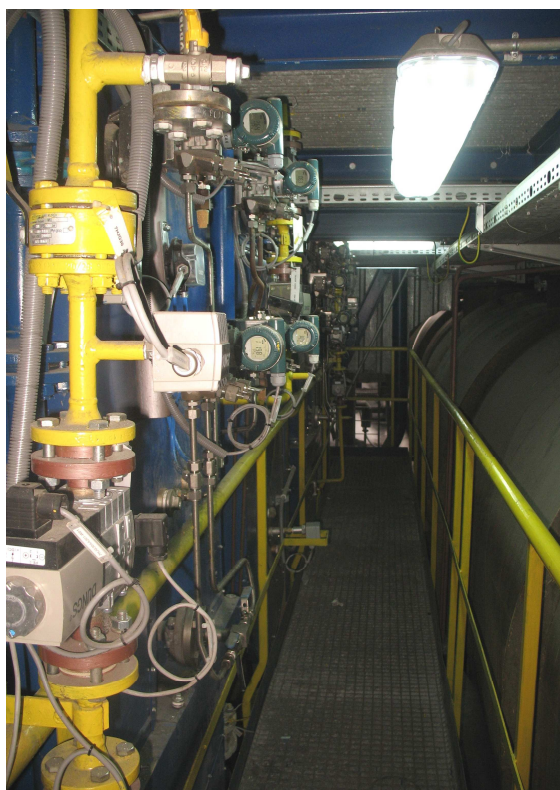
Fragment instalacji końcowej
