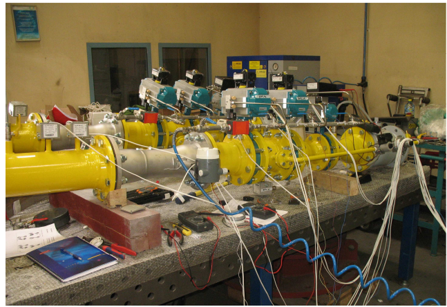
Ścieżki gazowe podczas odbioru technicznego FAT
