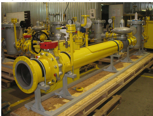
Stacje redukcyjne w hali produkcyjnej
